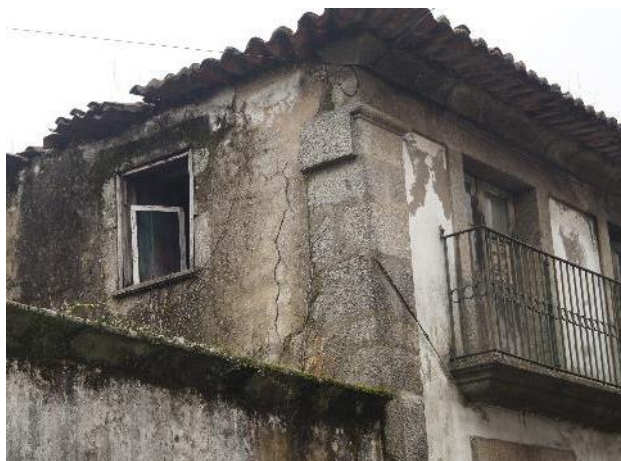
Figura 35. Fachada com desagregações
