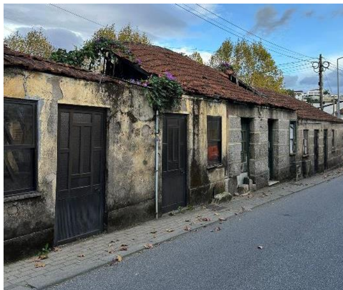
Figura 58. Edifício com deformações na cobertura
