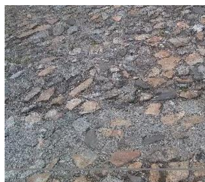
Figura 64. Pavimento irregular e degradado
