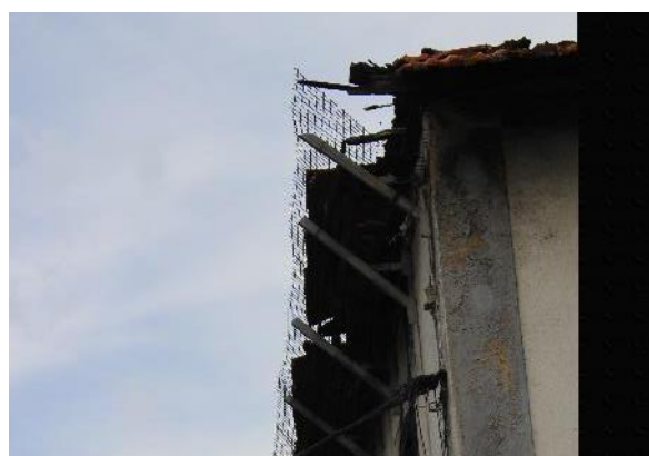
Figura 35. Cobertura parcialmente colapsada
