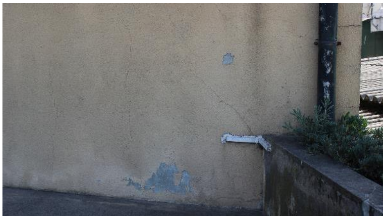
Figura 41. Fachada com manchas e desagregações
