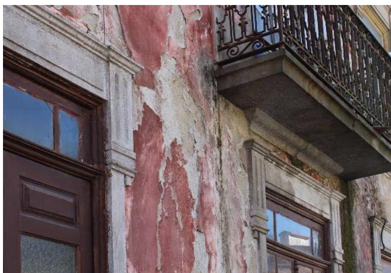
Figura 42. Desagregação de reboco e verdetes
