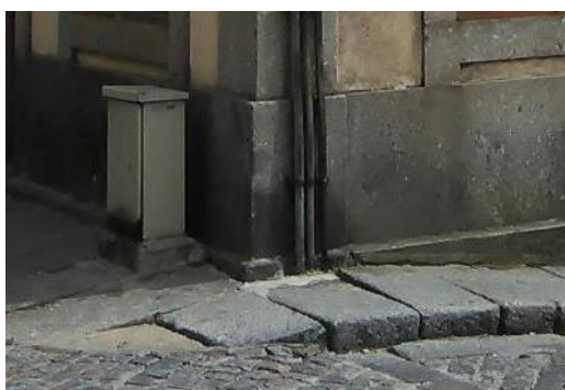
Figura 63. Pavimento irregular e degradado
