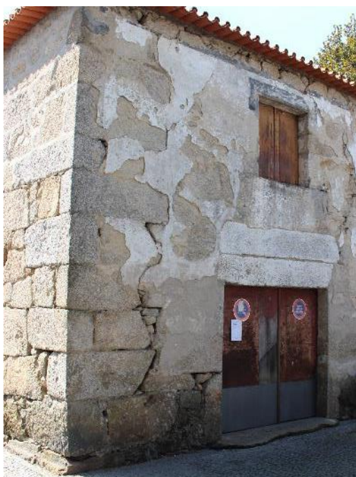
Figura 44. Deformação da fachada (cunhal esquerdo)
