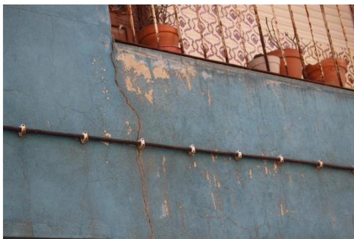
Figura 43. Fachada com fissuras
