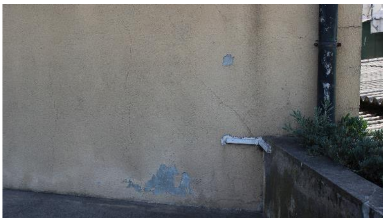
Figura 41. Fachada com manchas e desagregações
