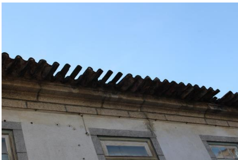
Figura 39. Beirado com telhas quebradas
