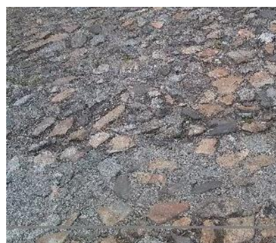
Figura 64. Pavimento irregular e degradado
