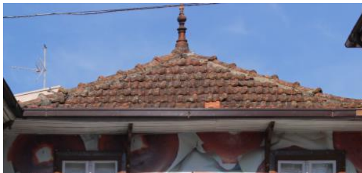
Figura 37. Cobertura com deslocamento/quebras das telhas
