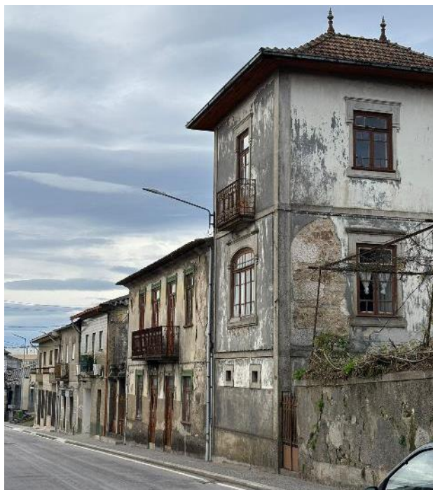
Figura 31. Casario degradado – Centro histórico de Felgueiras
