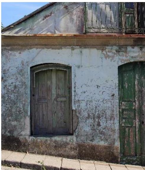
Figura 48. Ausência de caixilhos
