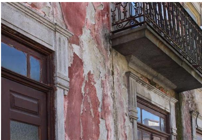
Figura 42. Desagregação de reboco e verdetes
