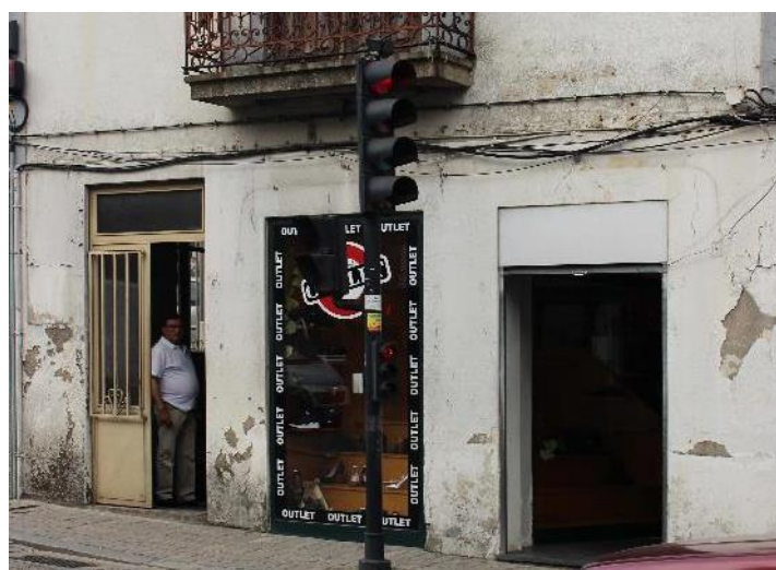
Figura 85. Exemplo de piso de comércio degradado
