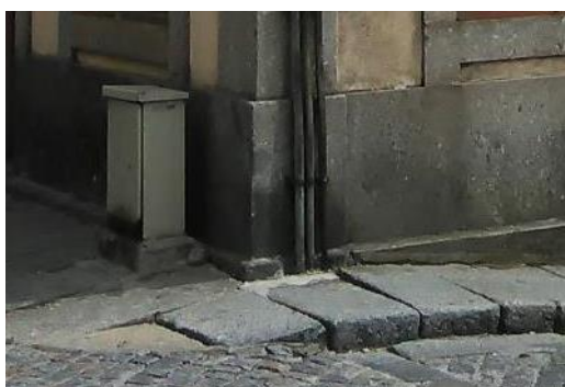
Figura 63. Pavimento irregular e degradado
