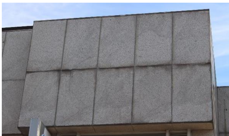
Figura 40. Fachada com eflorescências
