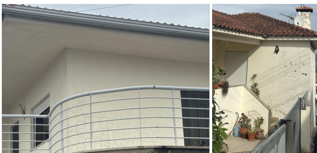
Figura 27. Fachadas com fissuras
