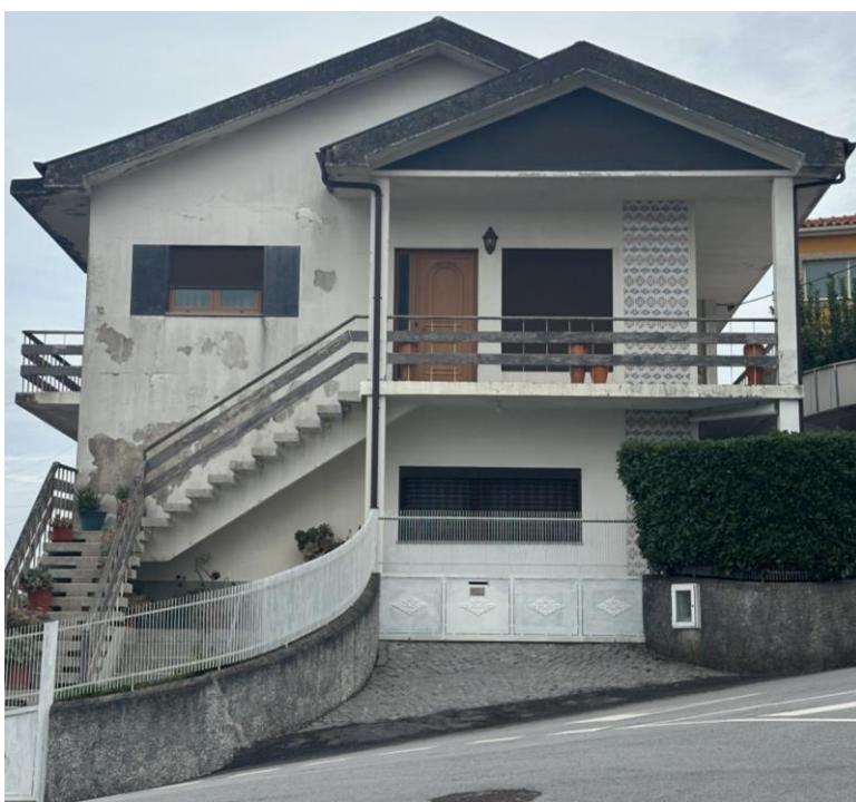
Figura 28. Desagregação do reboco
