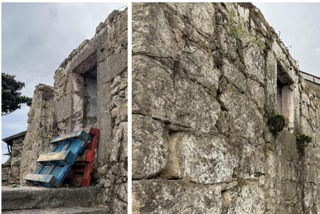
Figura 31. Edifícios com ausência de caixilharia
