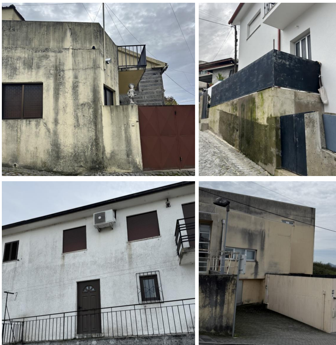
Figura 26. Manchas nas fachadas
