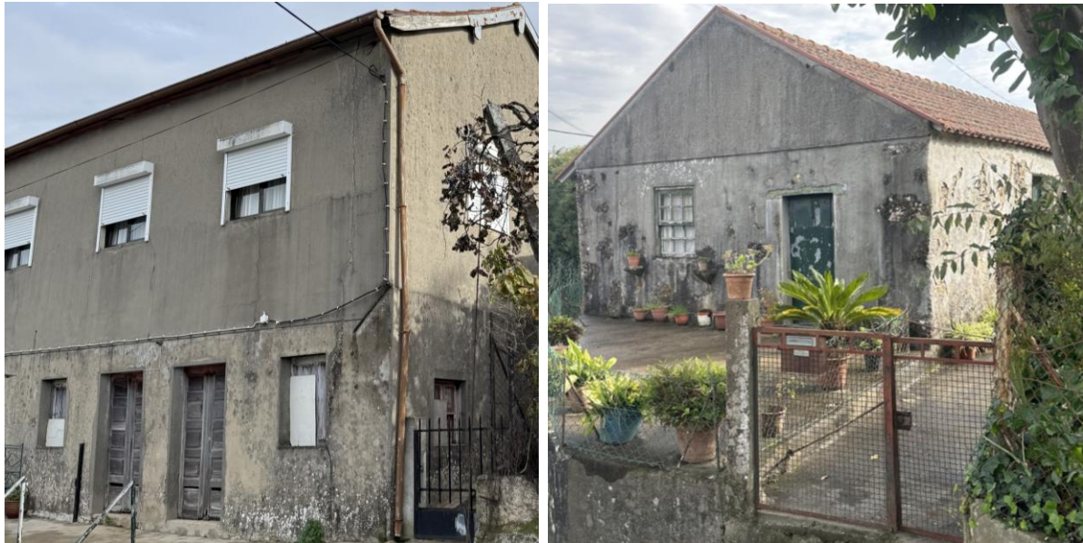
Figura 30. Fachadas com fissuras
