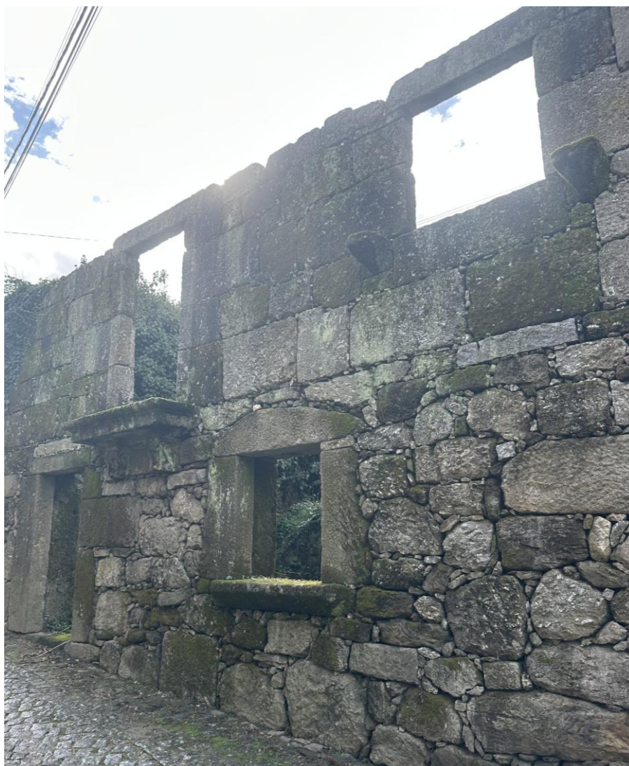
Figura 34. Edifício com ausência de caixilharia
