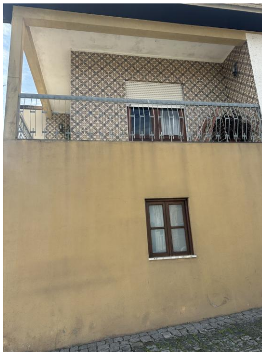
Figura 29. Manchas nas fachadas
