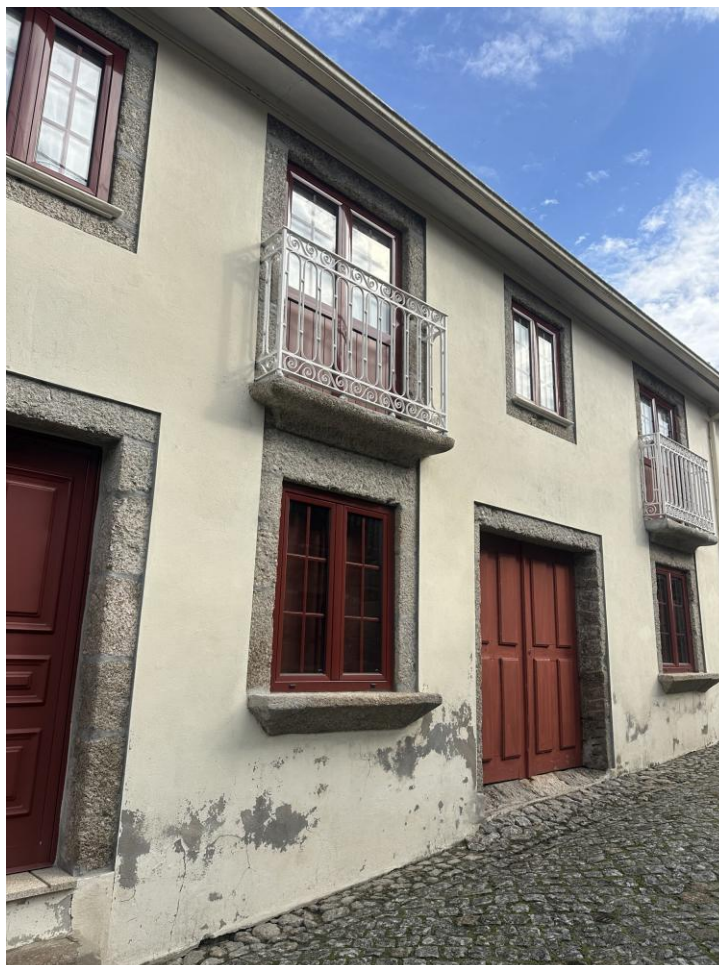
Figura 31. Desagregação do reboco
