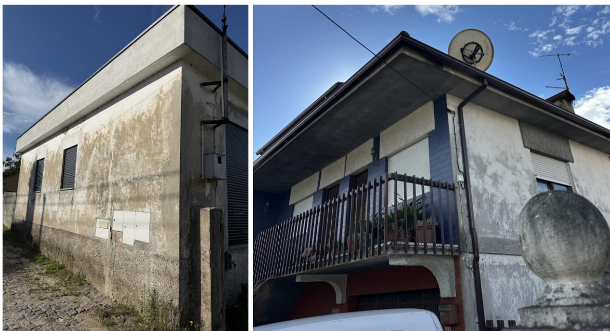
Figura 28. Desagregação do reboco
