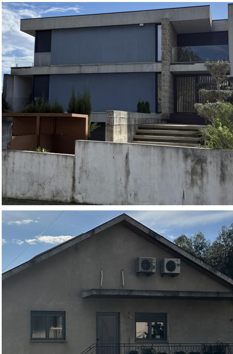
Figura 26. Manchas nas fachadas
