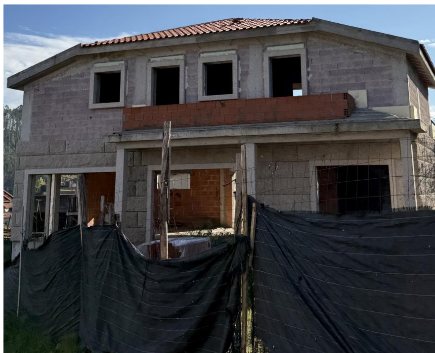
Figura 31. Edifícios com ausência de caixilharia
