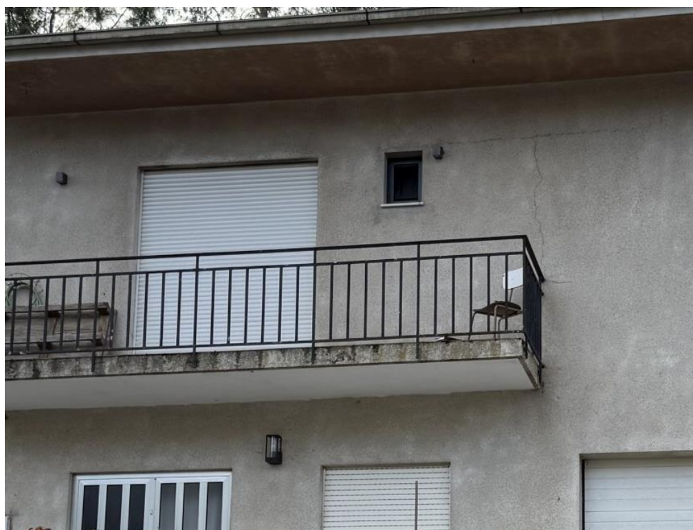
Figura 27. Fachada com fissuras
