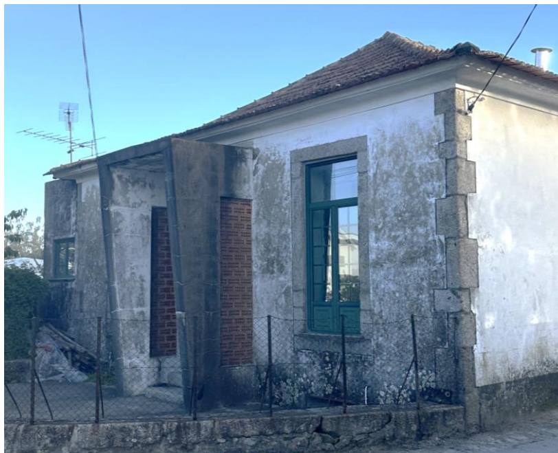
Figura 28. Desagregação do reboco
