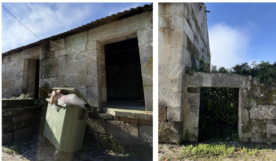
Figura 31. Edifícios com ausência de caixilharia
