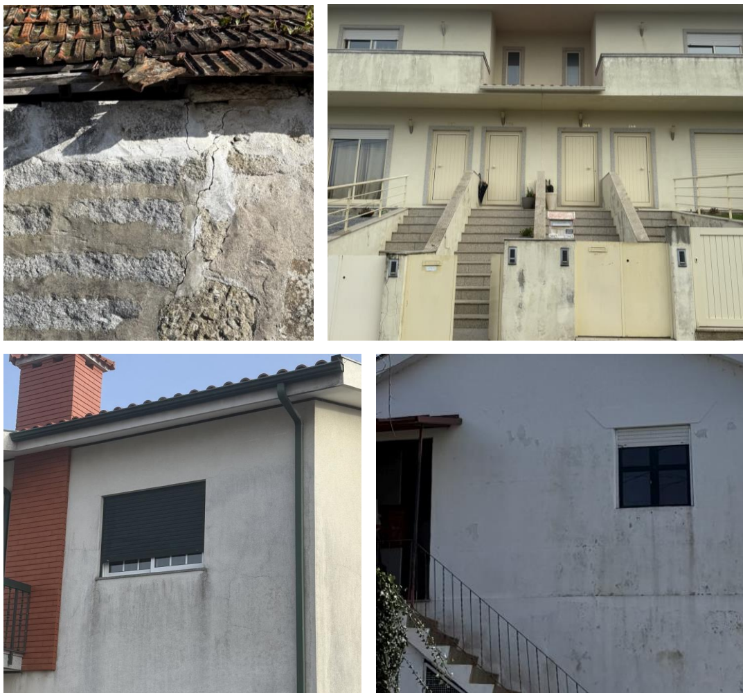
Figura 27. Fachadas com fissuras
