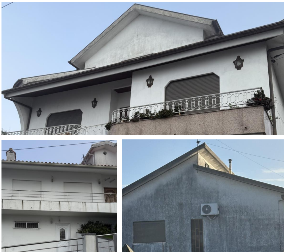
Figura 26. Manchas nas fachadas
